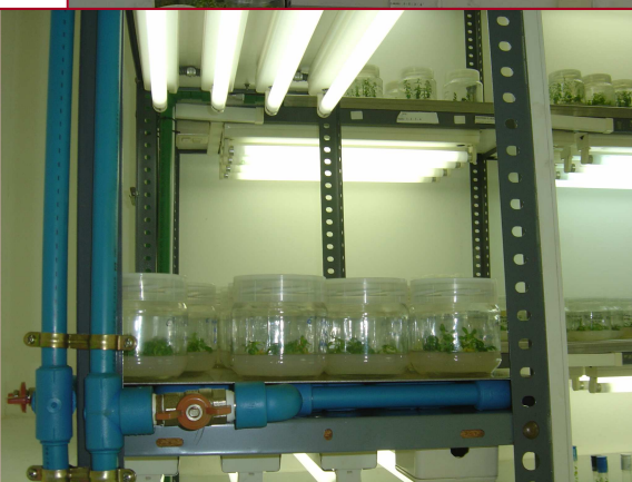
Sistema Bottom cooling
